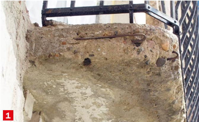
1 Erkélyrészlet sérült betonfelülettel, korrodált betonacél-betétekkel és korlátrögzítésekkel.
